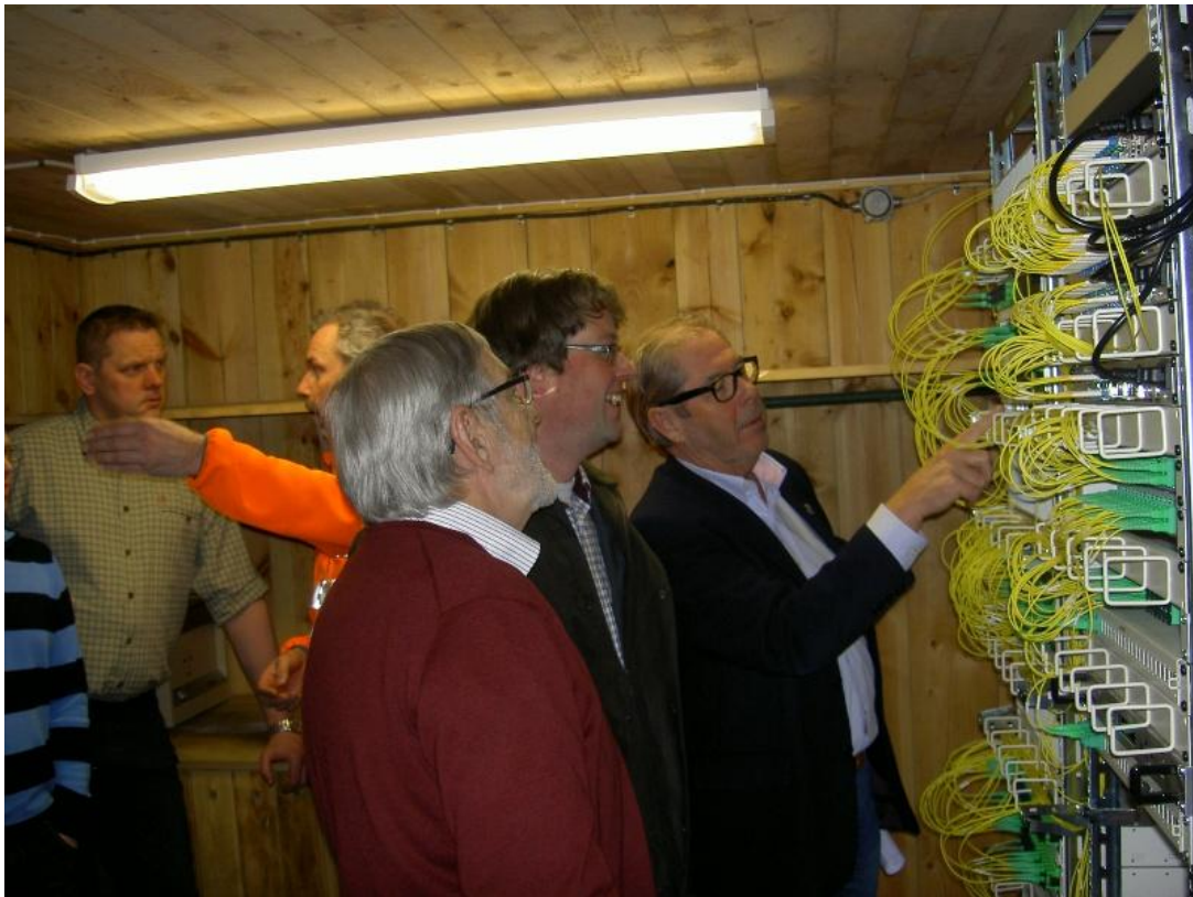
Efter lunchen gjordes ett besök i nodrummet i källaren. Sven-Åke, Marco och Keith kollar så att alla fiberkablar sitter rätt i noden.
